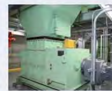
破碎・破袋装置 ホッパに投入された燃やすごみを、発酵に適したサイズまで細かく砕きます。
