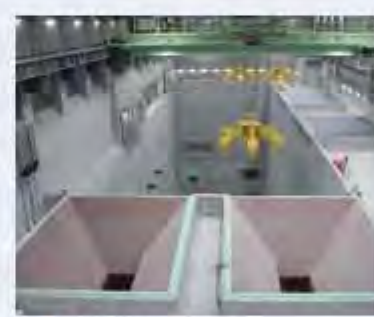
バイオガス化ホッパ ごみピットの燃やすごみをごみクレーンでバイオガス化施設用のホッパに投入します。
