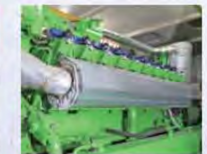
ガスエンジン バイオガスを燃料としてエンジンを動かし、発電を行います。出力は最大1,000kWで、年間発電量は、一般家庭の年間消費電力量のおよそ2,000世帯分です。
