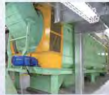
粒度選別機 穴がたくさん開いたドラムが回転し、その中を通る破碎したごみから比較的大きなものを取り除きます。アルミ選別機での選別精度を向上させることができます。
