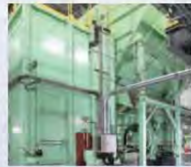
弾性ごみ切断機 弾性ごみを油圧で作動する切断刃で切断し、焼却施設へ送ります。
