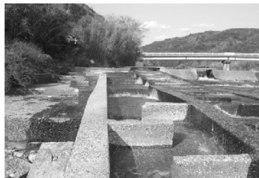
導壁式魚道。200 年近く前に開発された原始的なタイプの魚道だが、日本にはまだ多い。
