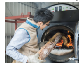
温泉施設の新ボイラー
